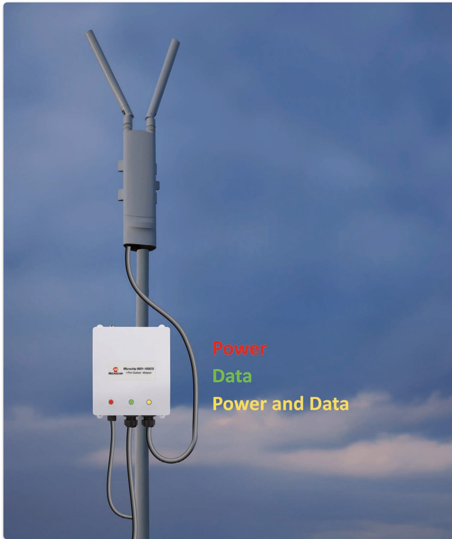
Ein Midspan versorgt einen funkbasierten Outdoor Access Point mit Strom
