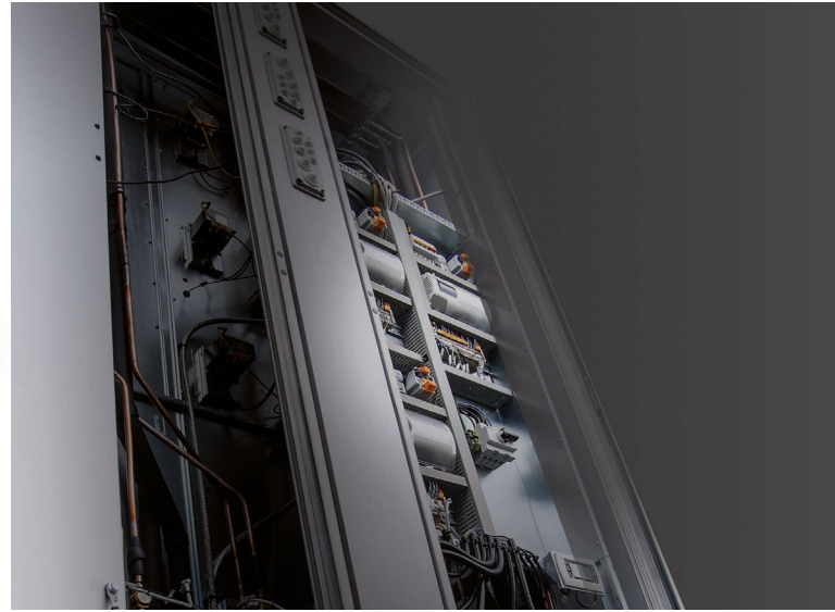
Retrofit einer Lüftungsanlage für eine bedarfsgerechte Steuerung
