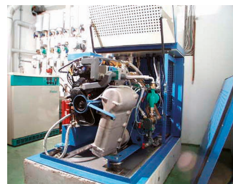
Blick in eine 8-kW-Anlage
