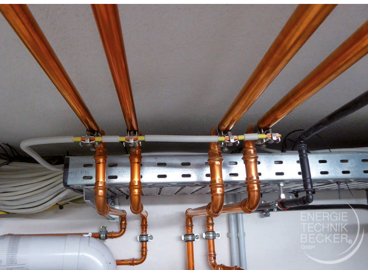
Der Potentialausgleich ist gemäß DIN VDE 0100 Teil 200 als „Elektrische Verbindung, die die Körper elektrischer Betriebsmittel und fremde leitfähige Teile auf gleiches oder annähernd gleiches Potential bringt“ definiert (Quelle: https://etb-karlsruhe.de/potenzialausgleich )
