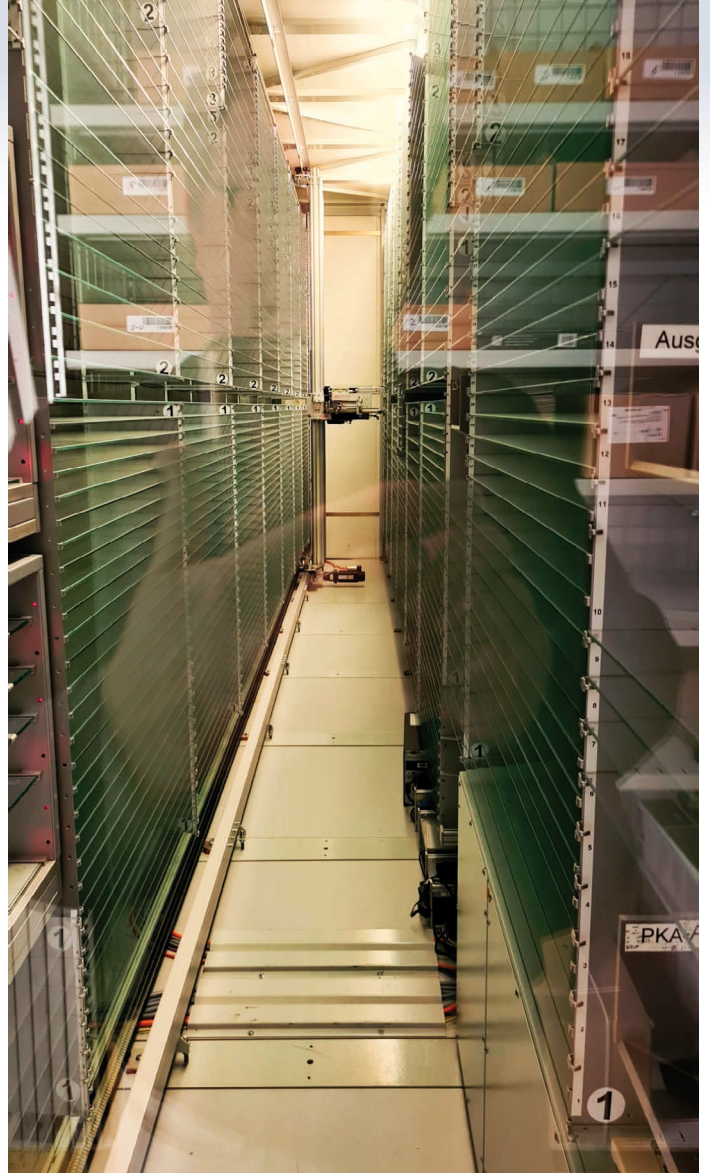
Bild 4: Blick auf die Maschinenbau-Seite einer kleinen Kommissionier-Anlage. Man beachte die sauber am Boden unter einer begehbaren Kabelbrücke verlegten Leitungen. © EFCO/Artemier
