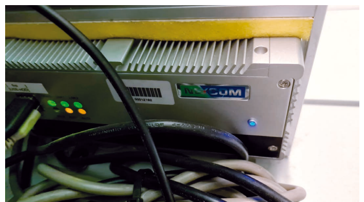
Bild 3: In der Praxis häufig anzutreffen: Eine unbefriedigende Einbausituation für den PC und ein eher chaotisches Verlegen der fertig konfektionierten Anschlusskabel. Man beachte den Unterschied zu Bild 4; im Bereich des Maschinenbaus sind die Kabel sauber und geordnet verlegt - und werden in aller Regel vor Ort konfektioniert. © EFCO/Artmeier
