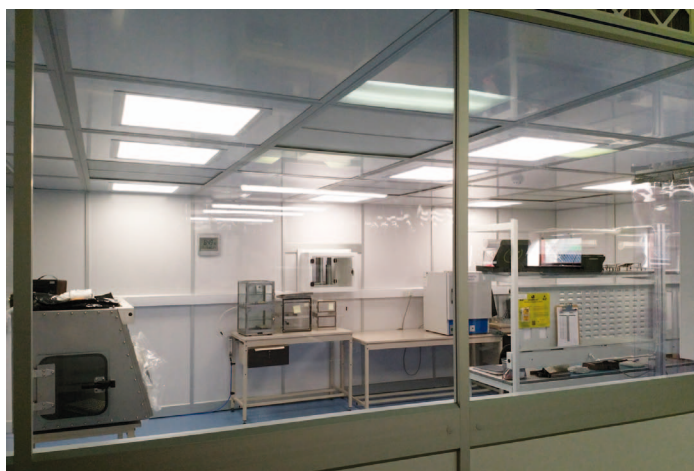
Bild 2: Reinraumanlage am Hauptsitz von Euroquartz Ltd. in Crewkerne, Somerset
