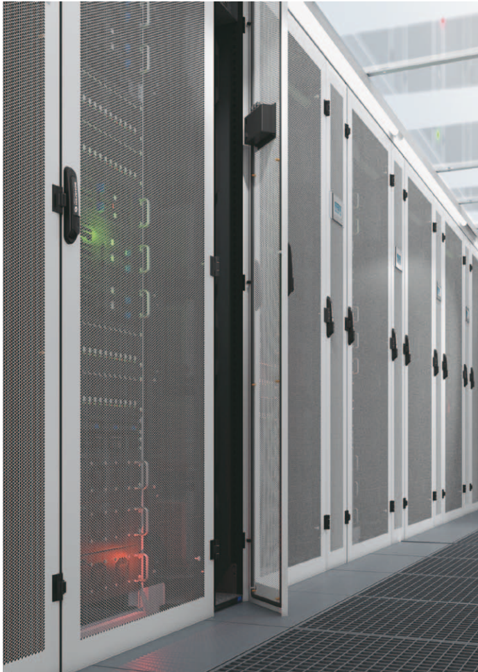
IT-Gehäuse in Rechenzentrumseinhausung © SCHÄFER WERKE GMBH
