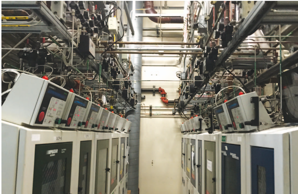
Bild 1: Metall und Stahlbeton – auch wenn zwischen Metallgestellen und Gasleitungen platziert, müssen drahtlose Zugriffsknoten funktionieren
