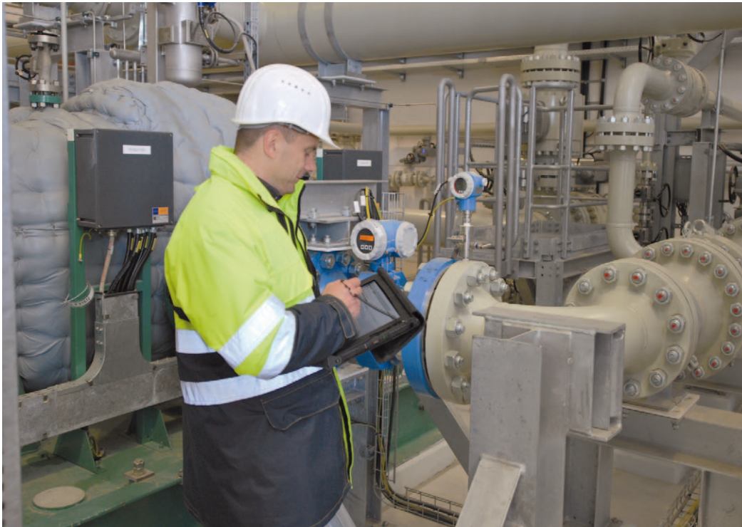
Bild 3: Die vom Regelwerk geforderte Aktualität der Dokumentation lässt sich dann mit dem Dokumentations-Tool LiveDOK realisieren. Sie kann z. B. per Tablet direkt vor Ort in der Anlage eingesehen und bearbeitet werden. (Quelle: Rösberg)
